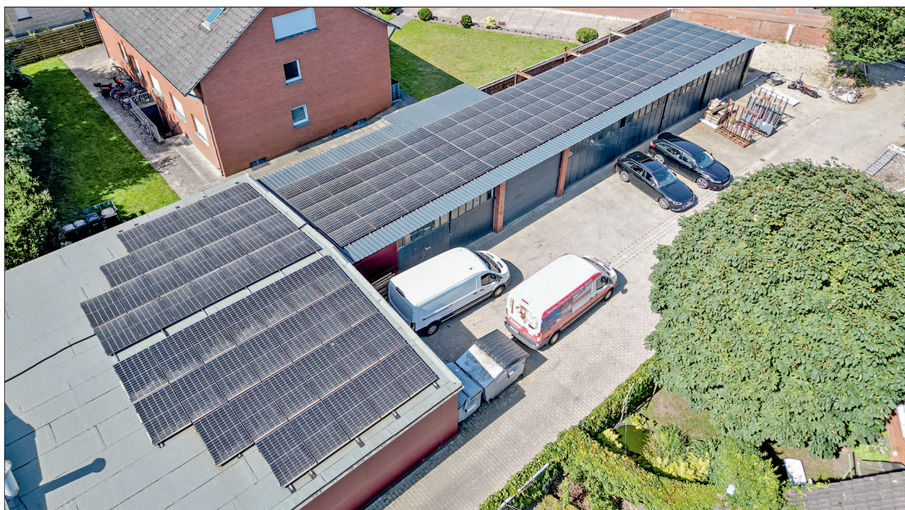
Über dem Lager auf dem rechten Teil des Gebäudes sowie über der Werkstatt sind insgesamt 140 PV-Module installiert, die genug Strom für den jährlichen Bedarf des Handwerksbetriebs produzieren. Tagsüber – von März bis November – liefert die PV-Anlage Überschüsse, die vor Ort gespeichert werden. Foto: Simone Reukauf/Köster Energie
