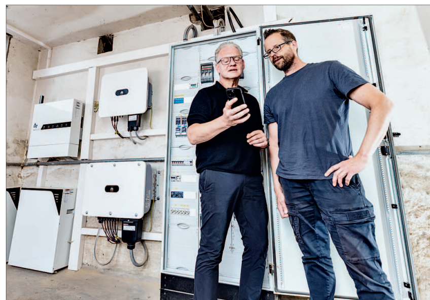
Um eine sichere Inbetriebnahme der Technik aus PV, Wechselrichtern und Speichern zu gewährleisten, weist Ulf Köster (links) auf sämtliche Betreiberpflichten hin. Links im Bild befinden sich die Speicher, rechts davon (neben dem großen Schaltschrank) die Wechselrichter.
